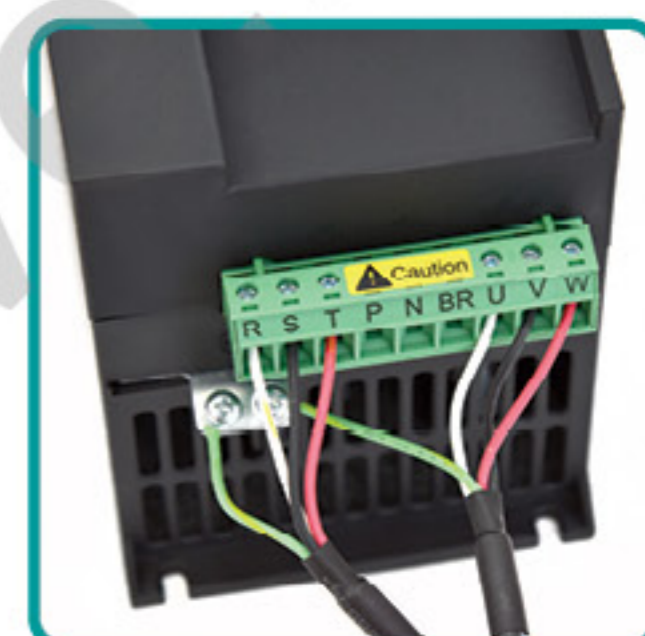
Подвод кабелей снизу
